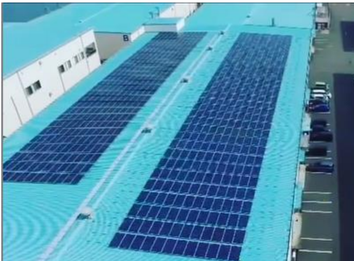
リユースパネルを用いた発電設備
